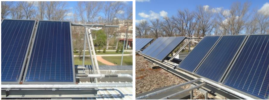
Painéis solares térmicos
