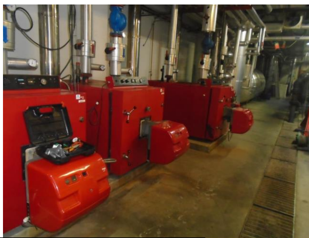
Caldeiras na casa das máquinas
