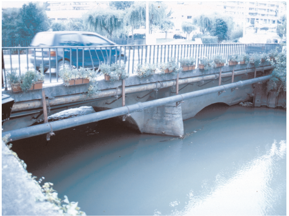
Ponte dos Caniços. Pormenor onde é visível o obstáculo que a ponte constitui à vazão do rio. Vista de montante para jusante.
