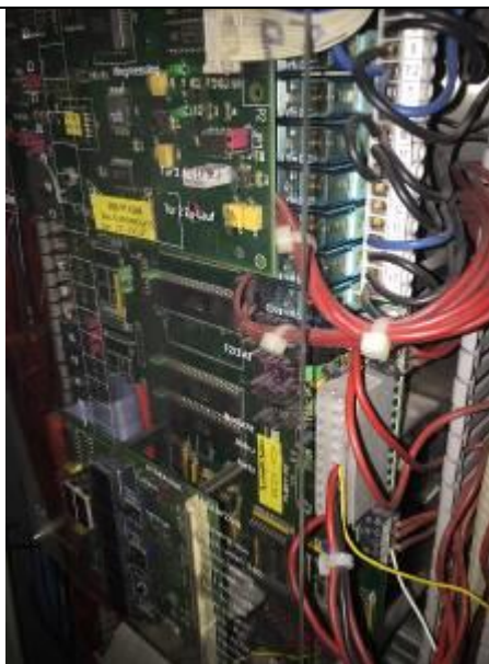
Elevador 7 (Monta cargas)
