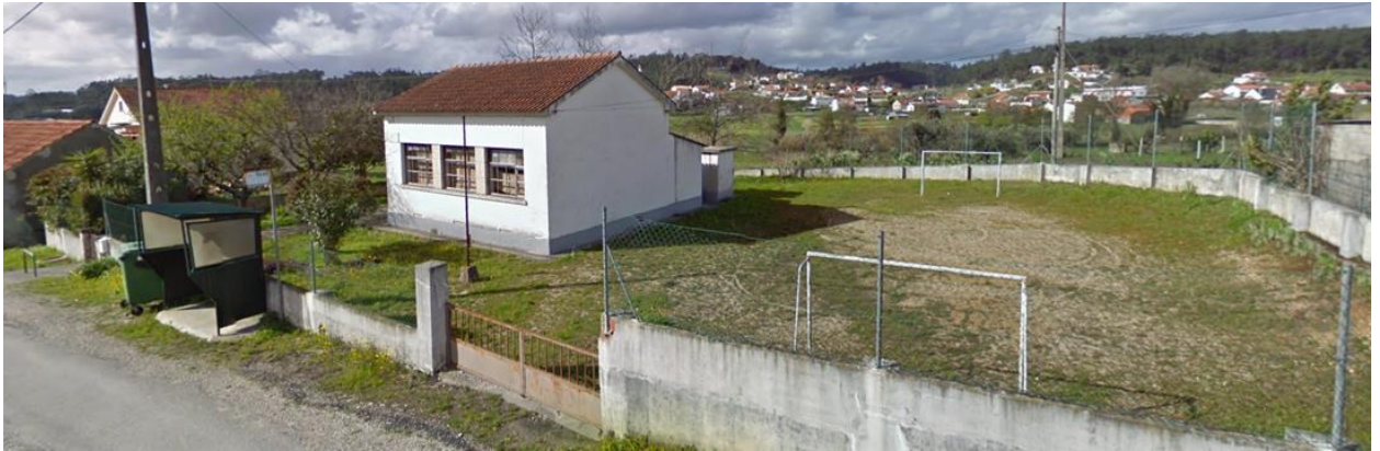
Zona do Pátio com sinais de abatimento do solo.
