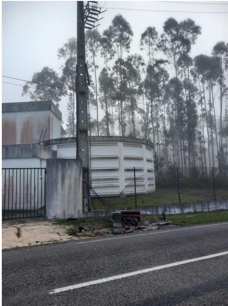
Aspetto do furto do cobre do transformador do posto de transformação da EEA Porto Carro
