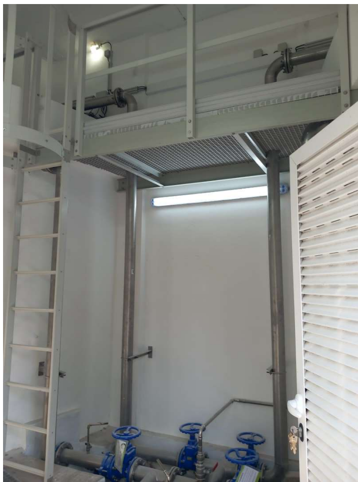
Parte da nova camara de manobras do R. Feijão.
