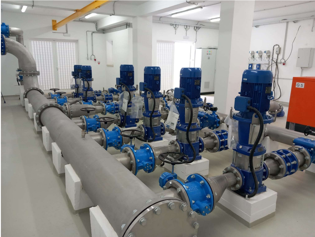
Aspetto da nova camara de manobras do R. Monte Redondo
