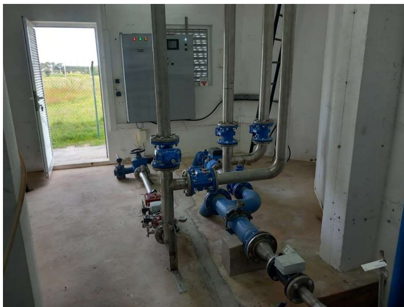
Aspetto da camara de manobras do R. Vale da Pedra.
