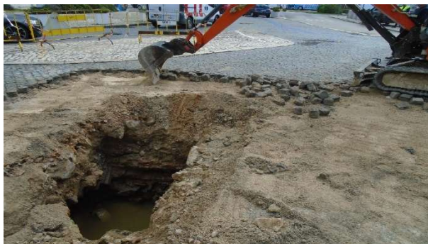
Vista do local onde o caneiro colapsou.
