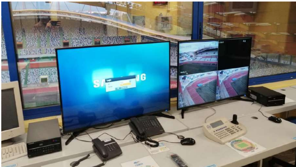
SALA DE CONTROLO E GRAVAÇÃO DE CCTV
