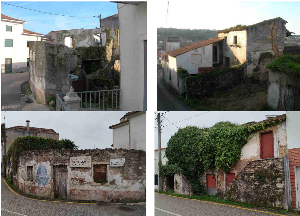
Figuras 14. Edifícios em ruína
