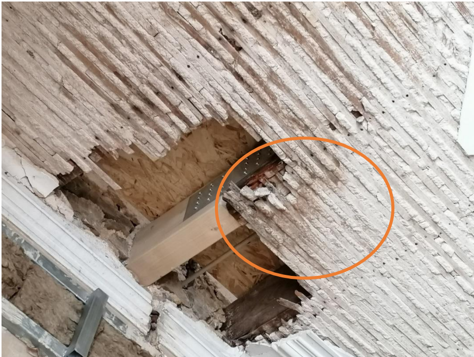
Figura 38 - Correção de viga junto à chaminé - madeira degradada sob a emenda já feita.
