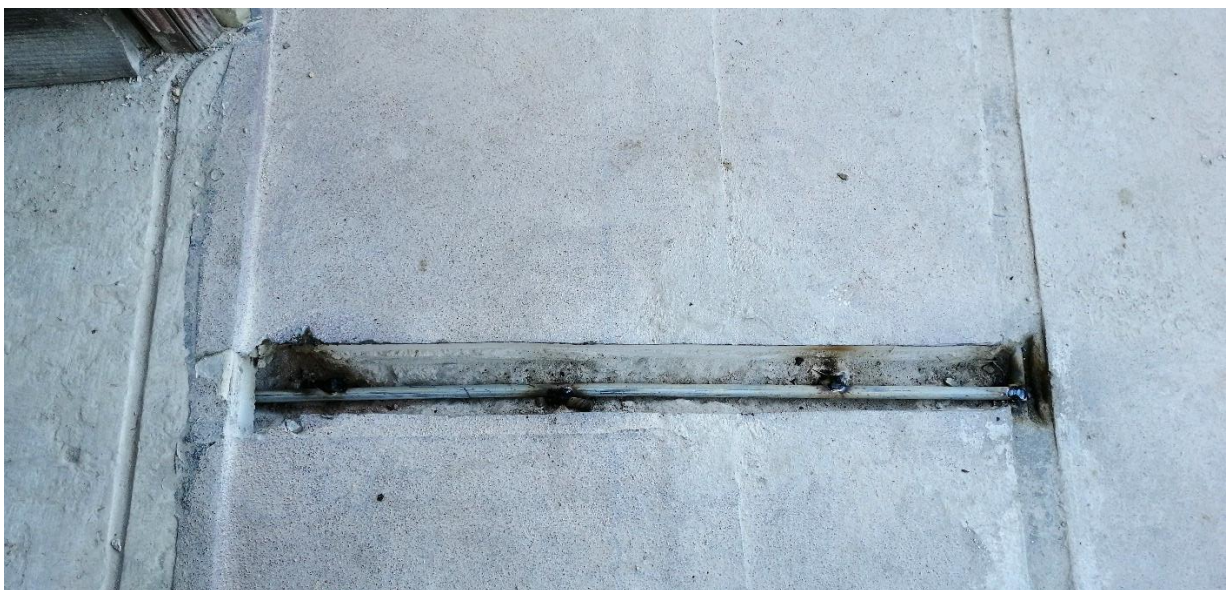
Figura 29 - Fixação dos tirantes com chumbadouro na laje superior da baywindow a norte
