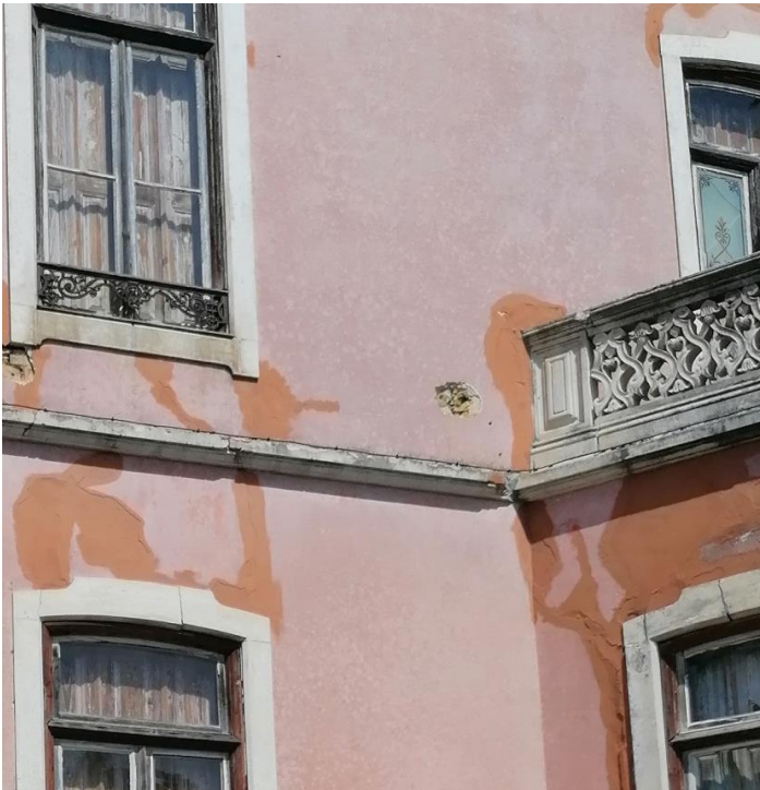
Figura 62 - Correção de desalinhamentos no friso exterior.
