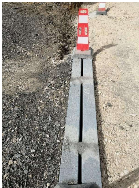
Fig. 4: Órgão de drenagem pluvial
