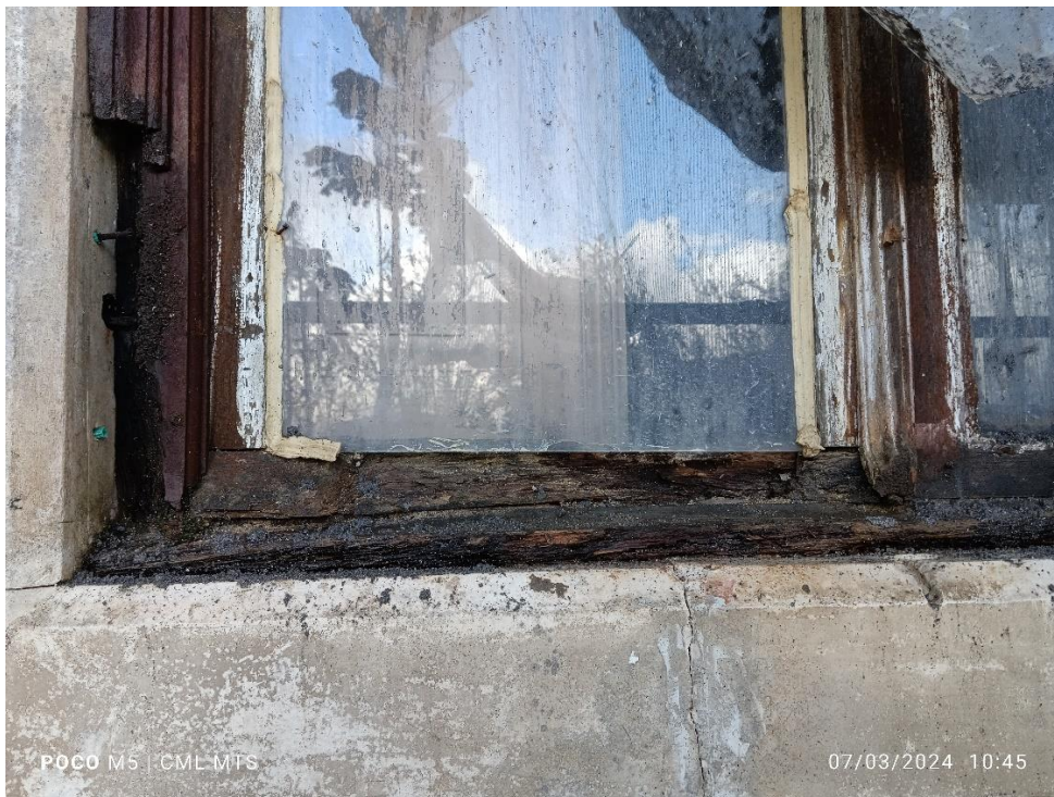
Foto 02 - Janela do piso 00 - podridão acentuada
