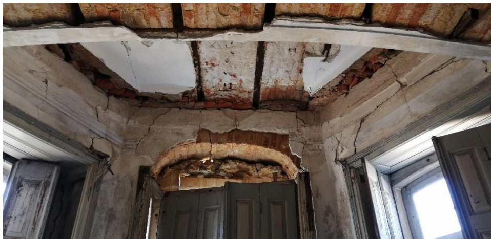
Foto 04 – a degradação dos paramentos e cantarias permitiu a entrada de água que degradou rapidamente as caixilharias
