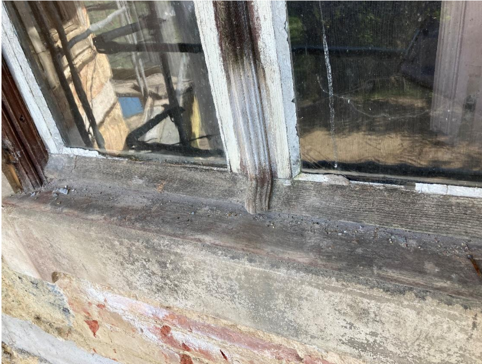
Foto 05 – Piso 01 – caixilharia degradada
