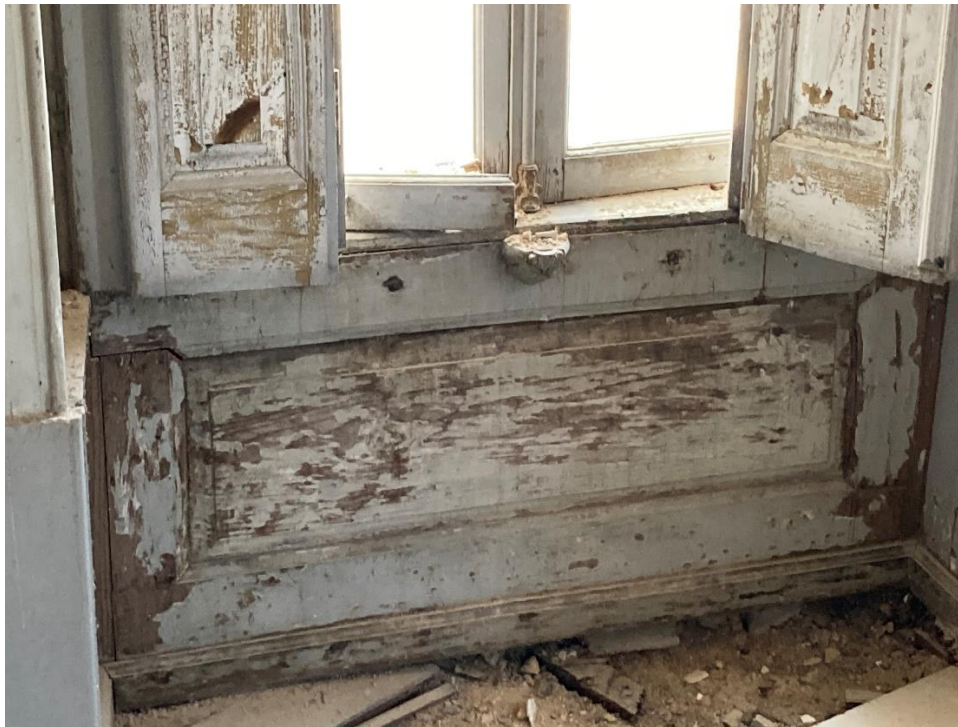
Foto 03 - Janela empenada e danificada pelas águas
