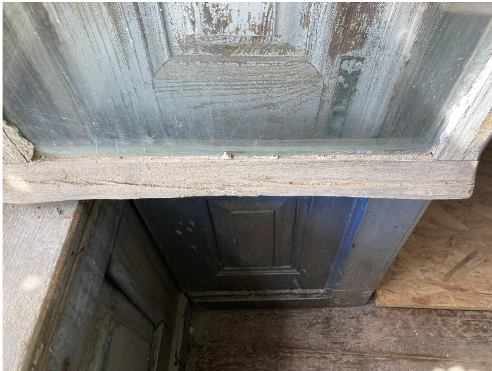
Foto 01 - Pingadeira de janela seca e corroída
