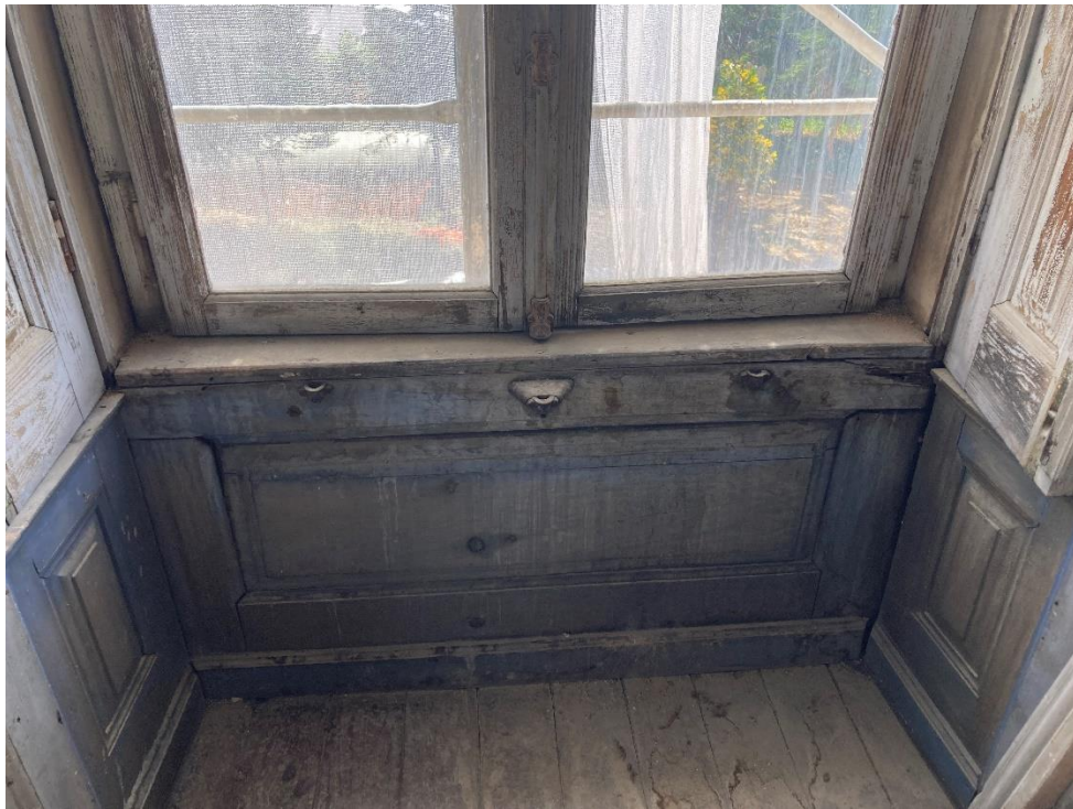
Foto 07 – Uma das melhores caixilharias, empenada e seca, fissurada
