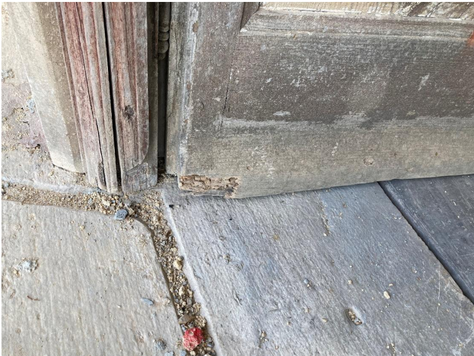
Foto 06 – Piso 01 – caixilhos apodrecidos, com perda de massa e fissurados
