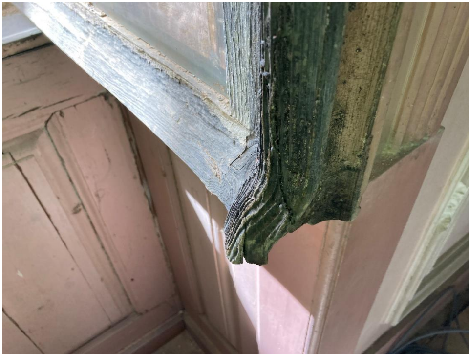
Foto 08 – elementos secos e corroídos
