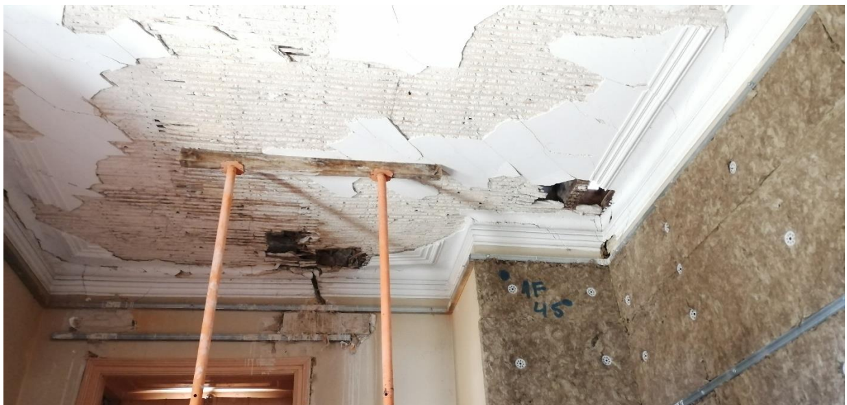
Foto 09 – elementos fissurados e descolados
