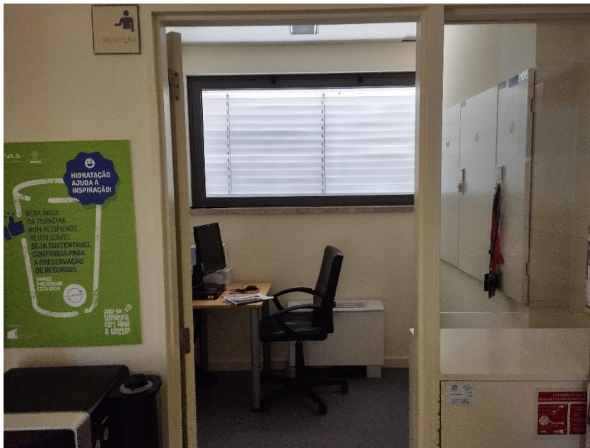
FIGURA 50 – INTERIOR: ÁREA DOS QUADROS ELÉTRICOS E POSTO DE VIGILÂNCIA NO PISO 0.
