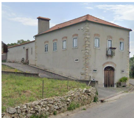
Foto11- Muro em risco de queda
