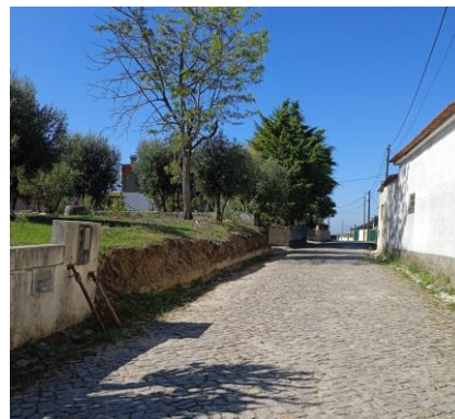
Foto 02- queda do muro
