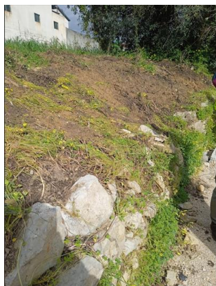
Foto12- Muro em risco de queda
