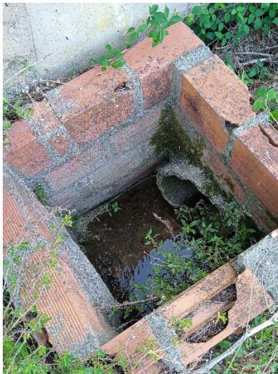
Foto05- Caixa existente danificada
