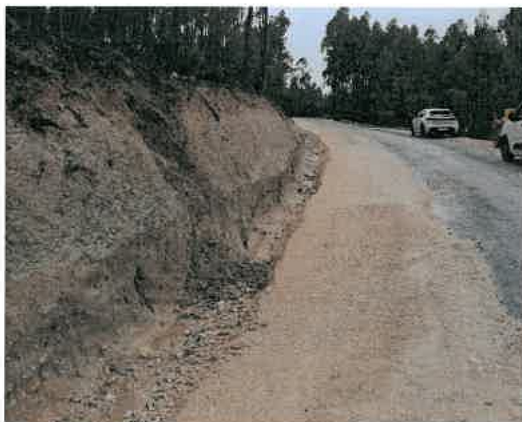
Figura 1 – Destruição da estrutura de pavimento e desmoronamento dos taludes.
