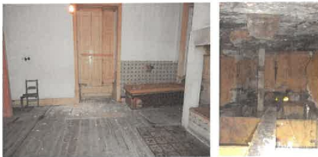
Figura 30 – “Degradação do pavimento na cozinha (esquerda) e solução de reforço adotada para mitigar a aparente perda de suporte junto ao lava-loiça (direita).”
