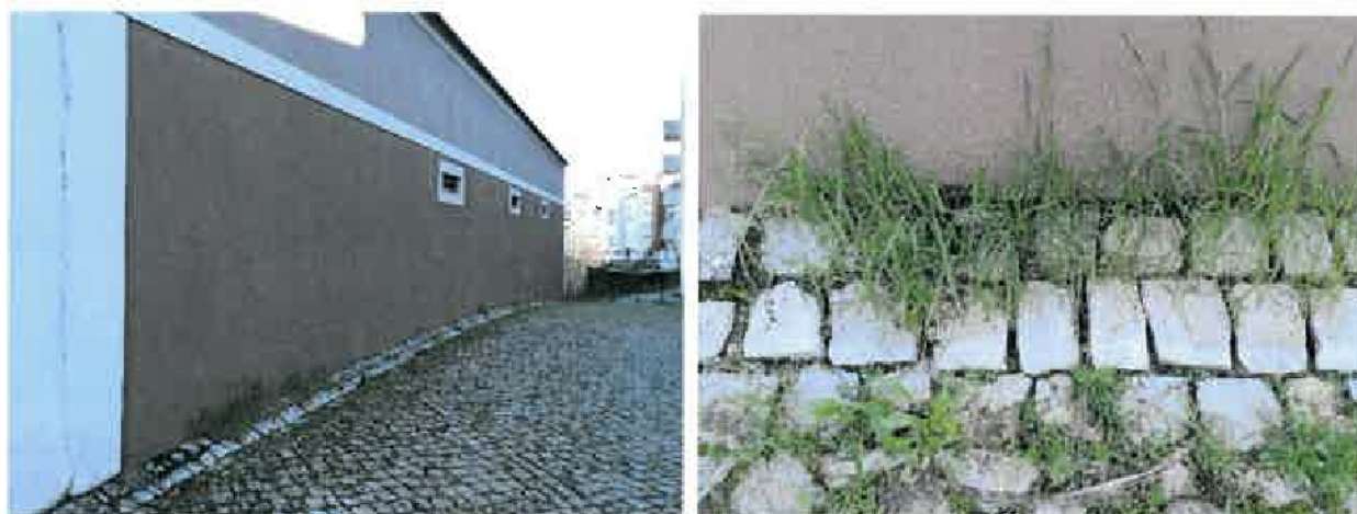
Paredes Edifício B, tardoiz, e pavimentação em mau estado
