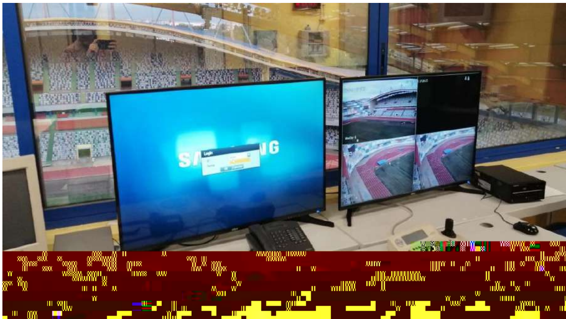
SALA DE CONTROLO E GRAVAÇÃO DE CCTV
