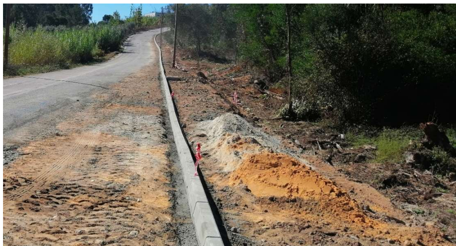
Figura 2 – Estrutura de base do passeio desprotegida.
