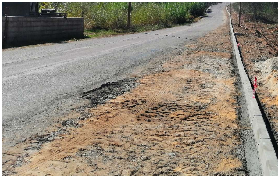
Figura 4 – Depressão junto ao eixo, diversas degradações nas bermas e alargamento assimétrico.
