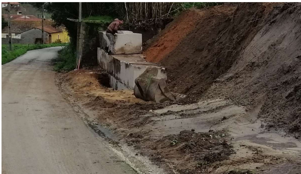
Figura 6 – Colocação de pedras a uma profundidade superior ao previsto.
