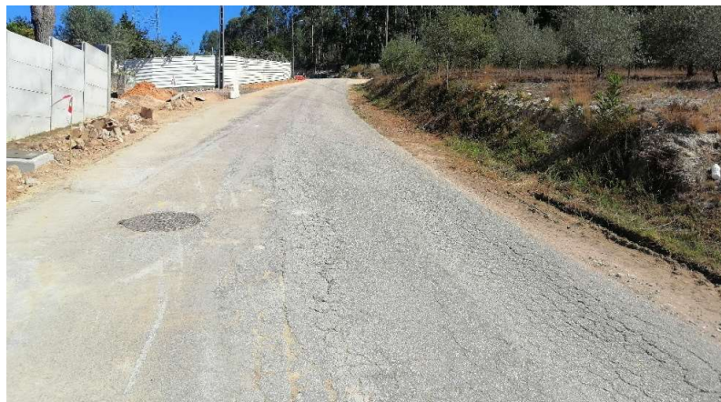
Figura 3 – Não existe previsto o encaminhamento das águas do lado direita da via.
