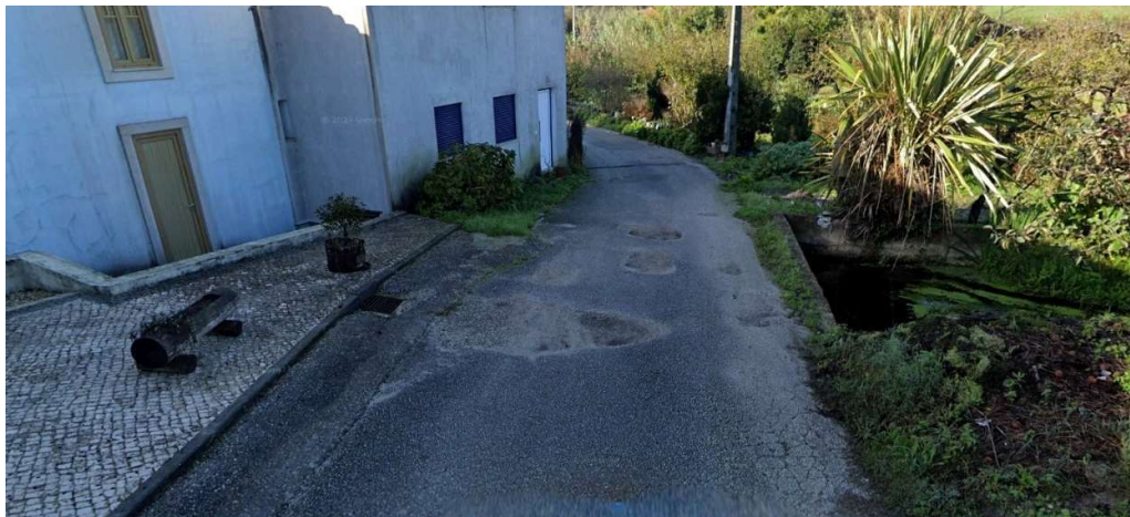
Figura 5 – Existência de depressão no pavimento na passagem hidráulica.
