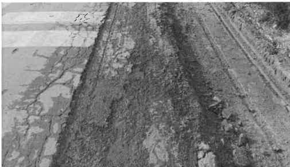
Figura 1 - Estado do pavimento existente.
