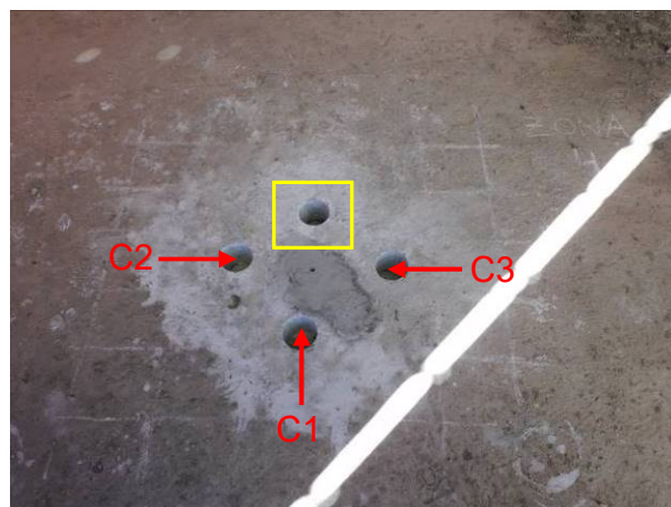
Fig. 33 – Idem. Idem. Idem. Pormenor. Presença dum orifício (assinalado a amarelo) em que a carote extraída revelou comprimento insuficiente para ensaio laboratorial.
