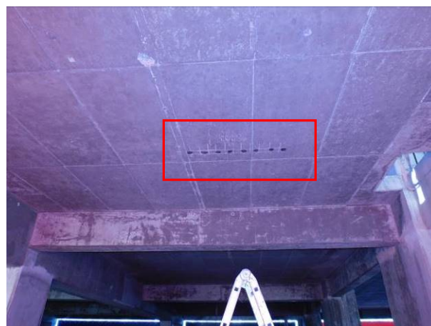
Fig. 35 – Idem. Idem. Zona Z(2).4, com realização de ensaios esclerométricos e ultrassónicos, através do método indireto, na face inferior da laje.
