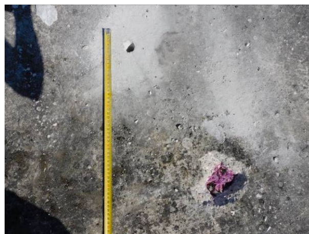
Fig. 47 – Idem. Piso 8. Pormenor da sondagem realizada na face superior da laje, para medição da profundidade de carbonatação. Furo de inspeção realizado para medição da espessura da laje.
