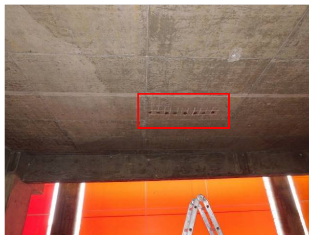
Fig. 23 – Idem. Idem. Zona Z(2).1, com realização de ensaios esclerométricos e ultrassónicos, através do método indireto, na face inferior da laje.
