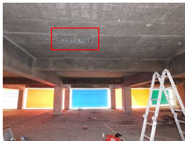
Fig. 27 – Idem. Idem. Zona Z(2).2, com realização de ensaios esclerométricos e ultrassónicos, através do método indireto, na face inferior da laje.
