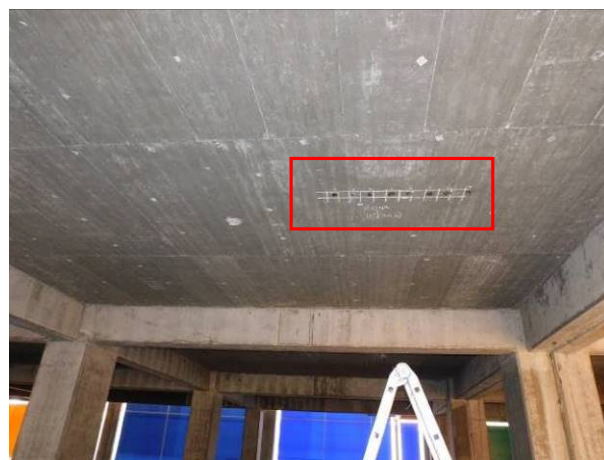
Fig. 31 – Idem. Idem. Zona Z(2).3, com realização de ensaios esclerométricos e ultrassónicos, através do método indireto, na face inferior da laje.
