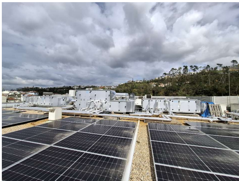
Aspeto do piso técnico do edifício de Laboratório.
