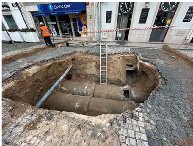
Vista da parte do caneiro que abateu
