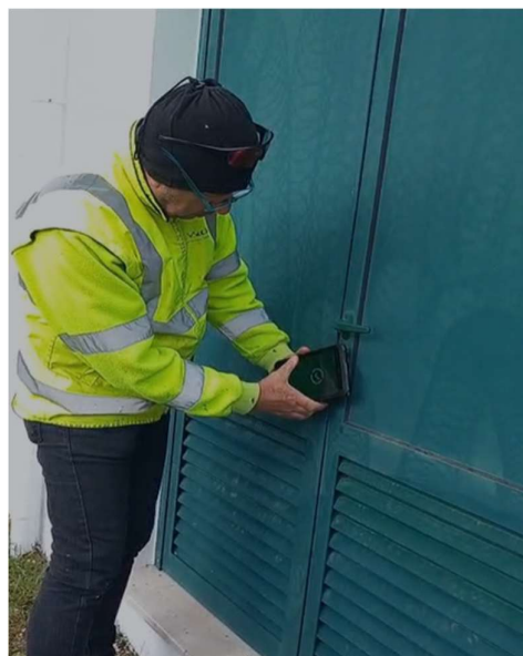
Sistema de gestão de acessos ILOC na EEAR Cerca
