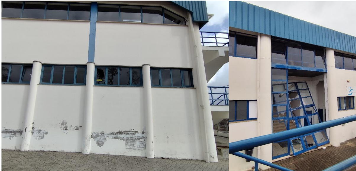
Fotos de danos em Pavilhões Desportivos Municipais
