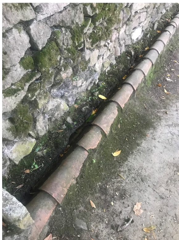
Figura 8: Sistema de caleiras existente.
