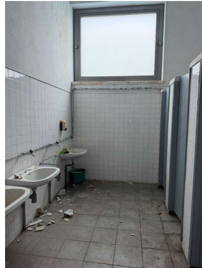
Figura 35A: Estado das instalações sanitárias na Unidade Suscetível de Utilização Independente C no Piso 1
