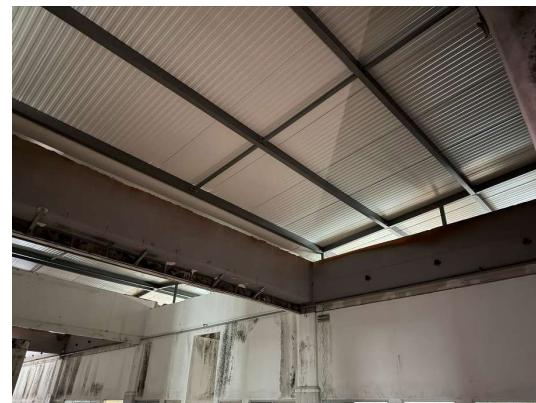
Figura 33A: Exemplo de remates da cobertura por concluir na Unidade Suscetível de Utilização Independente C no Piso 1
