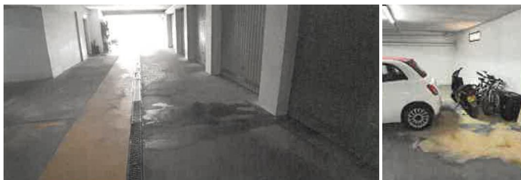
Figura 1 - Infiltração de água nas garagens do Lote 5 e Lote 7
