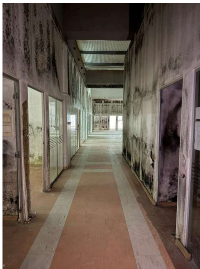
Figura 28 A: Estado da Unidade Suscetível de Utilização Independente C no Piso 1 com muitas patologias construtivas
