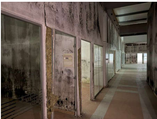
Figura 32A: Paredes da Unidade Suscetível de Utilização Independente C no Piso 1 com muitas patologias devido às infiltrações
