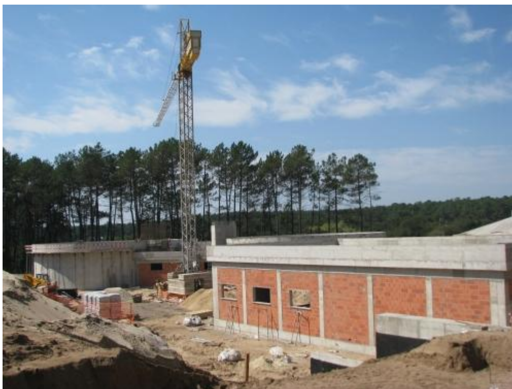
Figura 65. Reservatório e Estação Elevatória de Paúl/ Monte Redondo (à data da construção)
