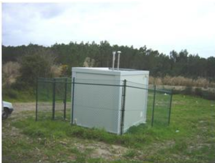
Figura 90. Estação de Monitorização da qualidade do ar de Ervedeira
