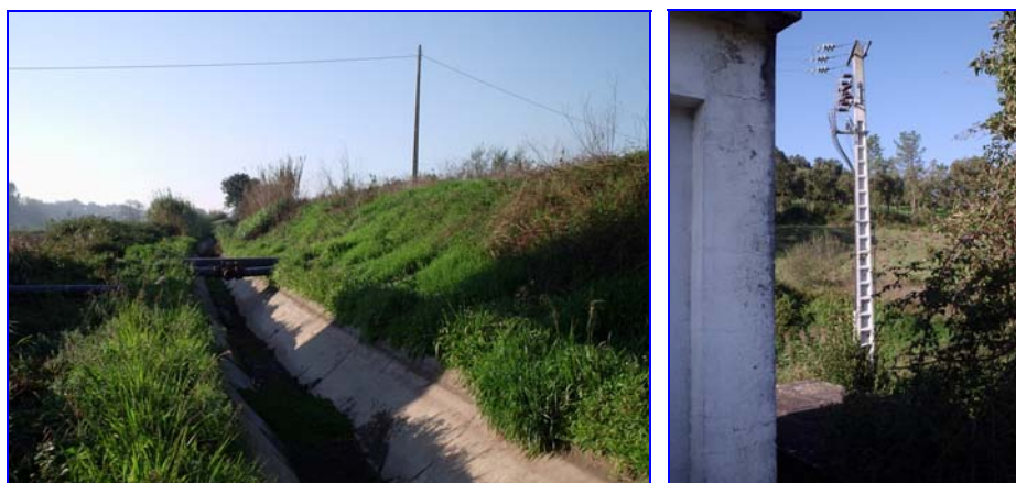
Fotografia 11 – Poste de Electricidade junto à EE Salgadas numa das motas do Rio Lis (esq.); Poste de Electricidade junto à EE Amor (dir.)
