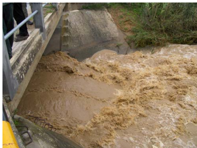
Foto 8 – Refluxo do rio Lis em face do rombo na margem do Colector de Monte Redondo
