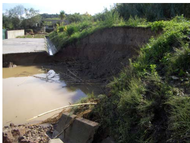
Foto 12 – Rombo na margem direita do rio Lis e estragos no canal de rega 12 (I) e zona confinante [dia 26]
