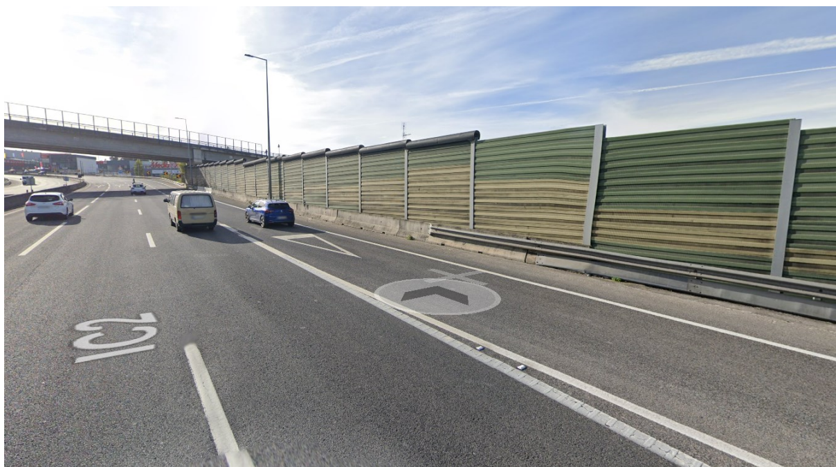
Figura 6-1 – Exemplo de barreira acústica instalada na A19 / IC2 – Nó do IC36 / Nó da EN109
