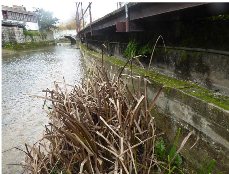
Fotografia 5 – Ocupação por construções e redução do leito de cheia (Coord.: Lat. 39°41'6,77"N; Lon. 8°46'16,33"W)
