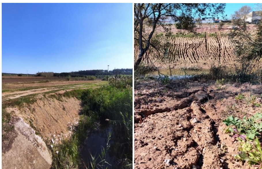
Figura 30 – Erosão e instabilidade de margens – situações não críticas
