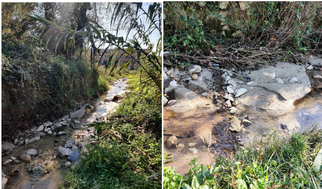
Figura 13 – Intervenção na ribeira do Amparo com técnicas de Engenharia Natural (em cima, durante a empreitada, a 06/2020, em baixo, 18 meses depois, a 11/2021 – pormenor de soleira em bio rolo já envolta em sedimentos)
