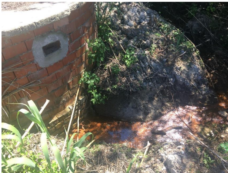
Fotografia 14 – Descarga de efluentes contaminados para a linha de água (Coord.Lat. 39°49'48,97" N; Lon. 8°43'18,16 W)
