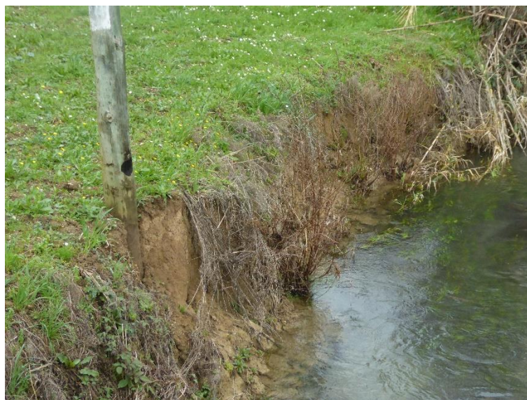
Fotografia 10 – Erosão marginal (Coord.Lat. 39°41'13,23''N; Lon. 8°46'41,66W)
