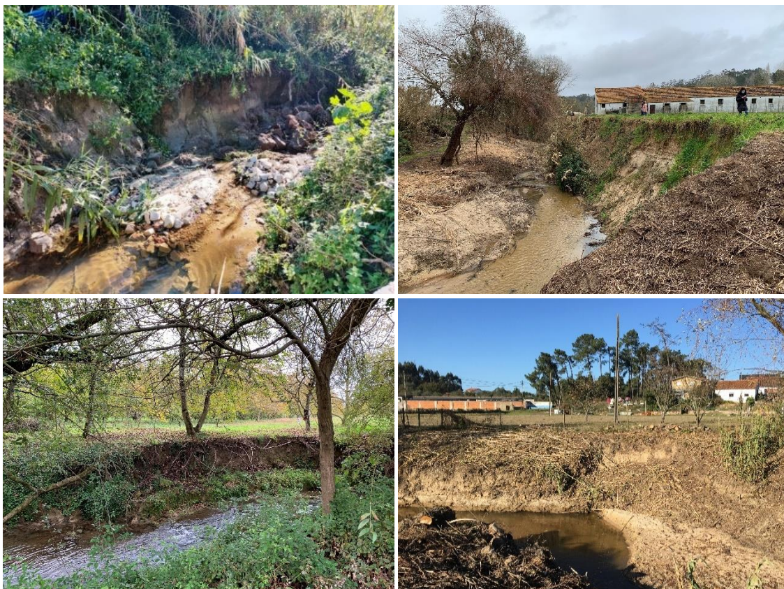
Figura 31 – Erosão e instabilidade de margens – situações graves
