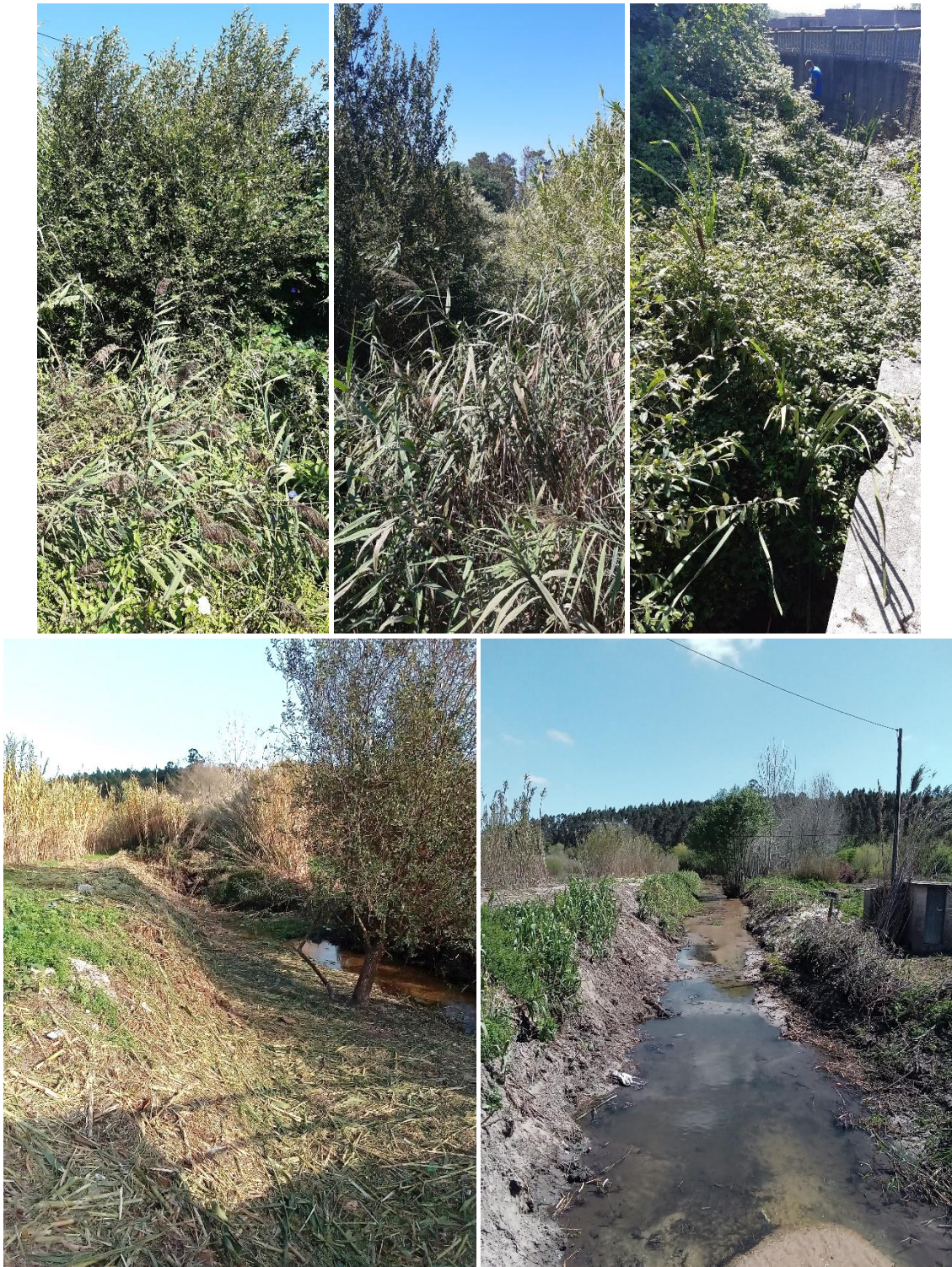
Figura 17 – Ribeira de Amor (antes e depois da intervenção, em cima e em baixo, respetivamente)
