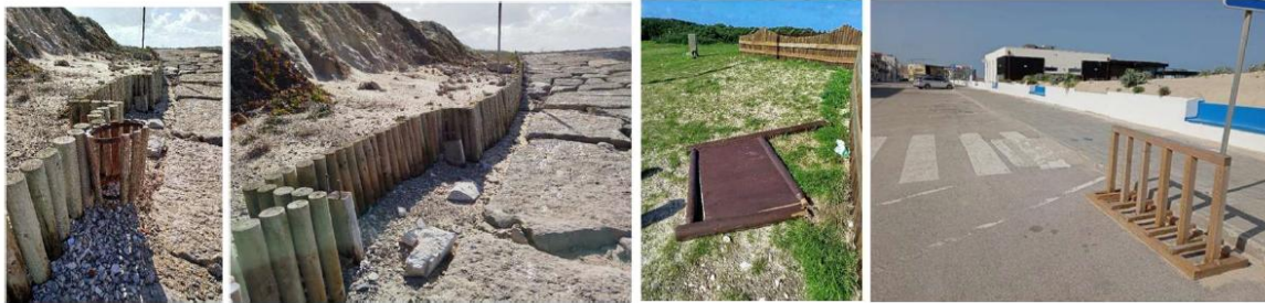
Figura 22 – Danos na Praia do Pedrógão
